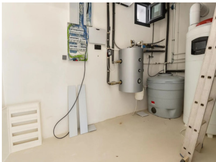
Technikraum der energieeffizienten Villa
