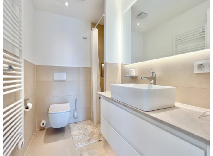
Badezimmer mit Heizung
